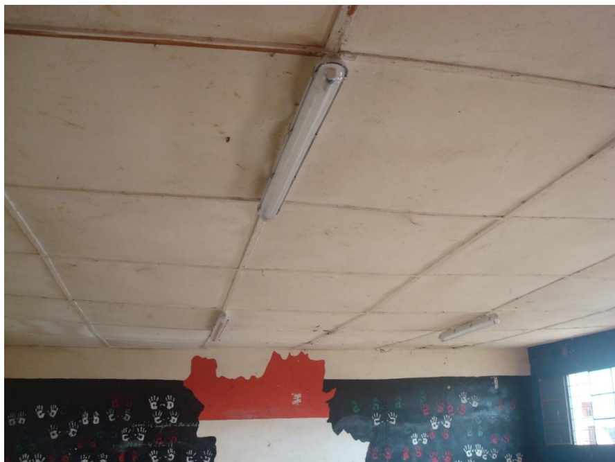
Buitenverlichting en TL armaturen, alles met zuinige LED lampen
