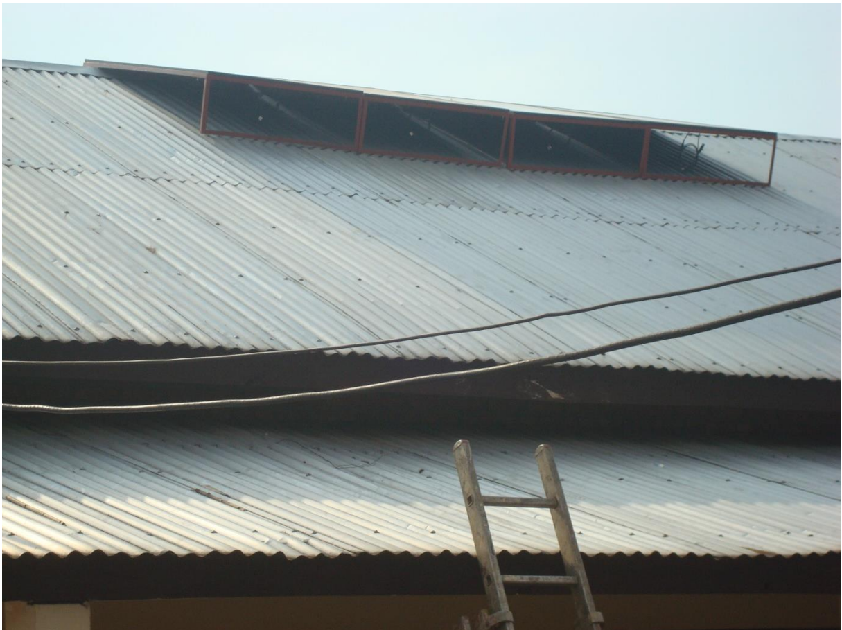
En geïnstalleerd op het dak van de ontspanningsruimte en computerlokaal.
